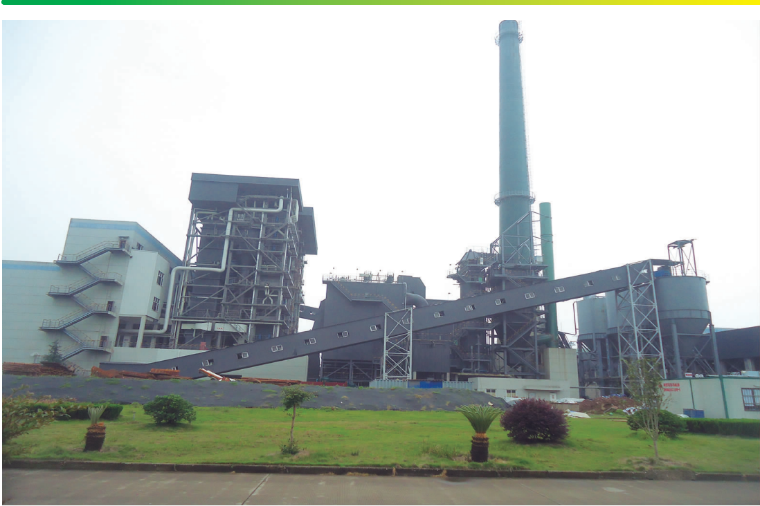
▲新安集团马目热车间除尘和脱硫装置
