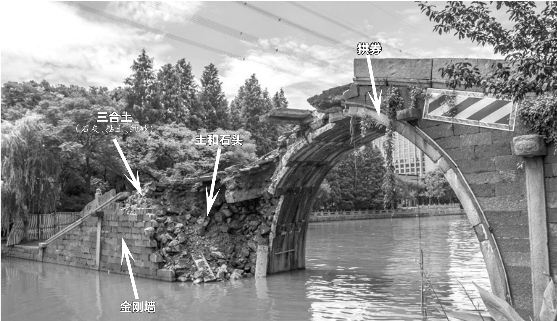
昨天上午，发生断裂垮塌的欢喜永宁桥已经封闭。
