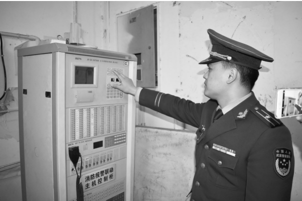
宏腾生活广场火灾自动报警系统有故障
