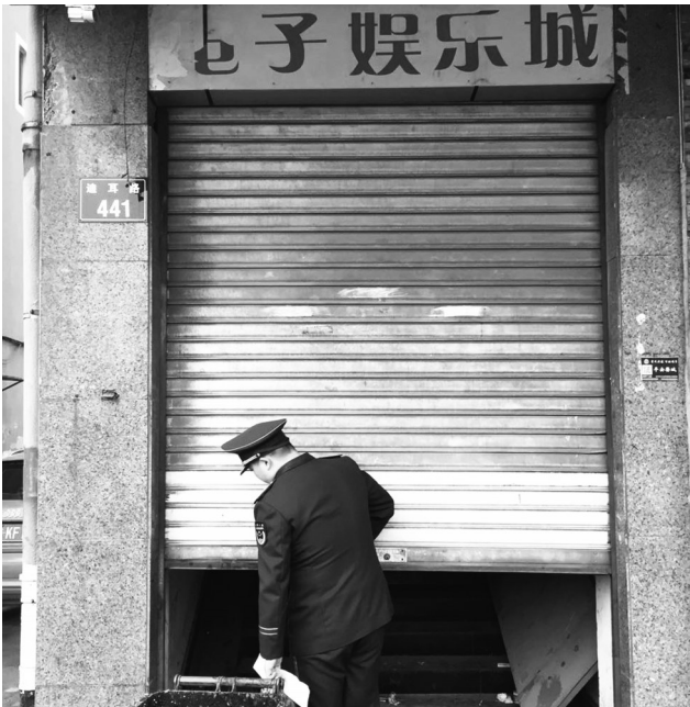
卫星宾馆封闭楼梯间首层安全出口设置卷帘门
