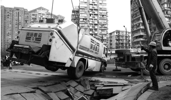
垃圾车被吊起后，塌陷的大坑完整显现。记者 葛亚琪 摄
