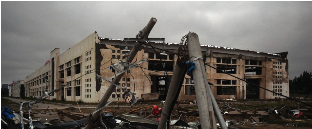
阜宁一处受损严重的厂房
