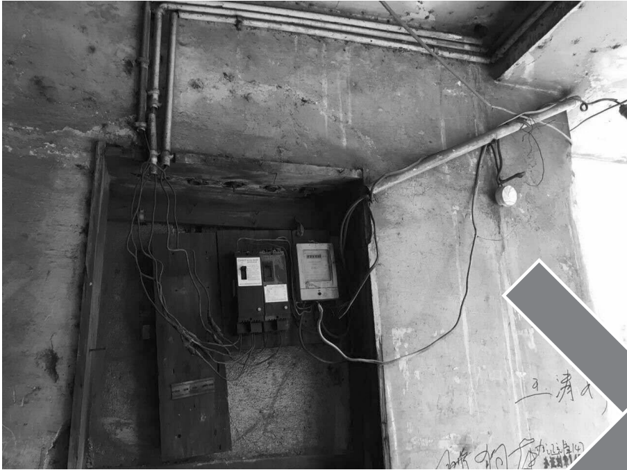
出租房电线凌乱、部分电线未套管
