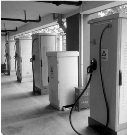
杭海路南侧公共停车楼充电桩
