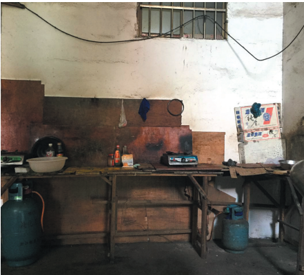
消防在检查中发现,出租房私拉电线,堵塞消防通道的现象很普遍。
