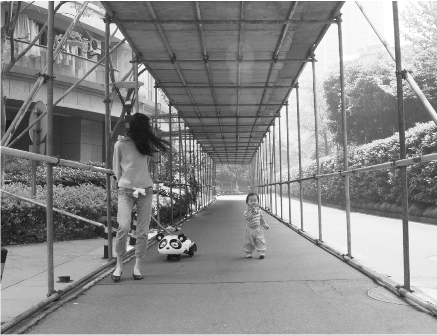
为防墙体脱落伤人,业委会花6万元搭了三处这样的脚手架。
